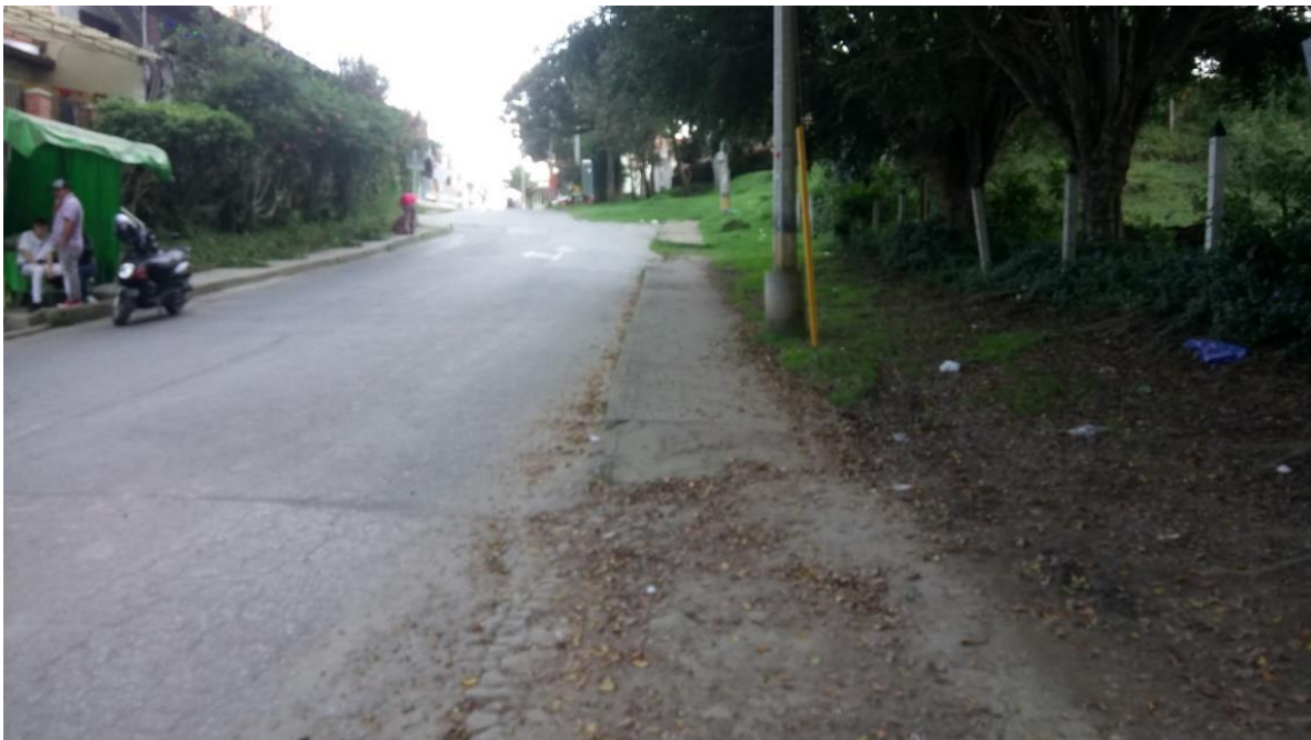
Figura 4.6-2 estado de los andenes de la calles 41
