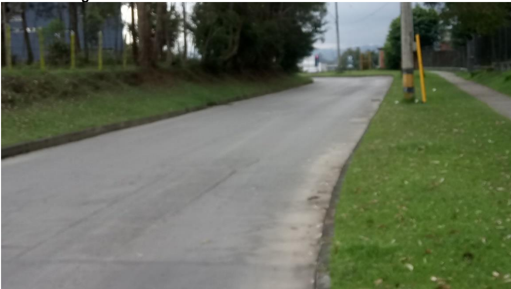
Figura 4.4-2 fallas en la carpeta asfáltica de la Calle 41
