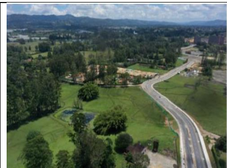
Figura 30. Construcción, ampliación o adecuación de vías urbanas y rurales 2022. Corregimiento Sur: Villas de Llanogrande-Alto Vallejo (vía nueva, transversal 2).
