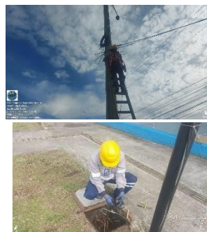
Figura 71. Mantenimiento y expansión del sistema de alumbrado público 2022. Corregimiento Sur.
