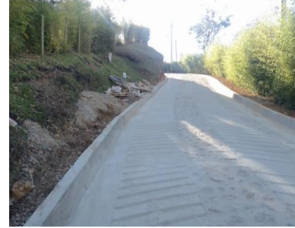
Figura 33. Construcción, ampliación o adecuación de vías urbanas y rurales 2022. Corregimiento Sur: Placa-huella Santa Teresa.
