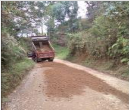
Figura 39. Construcción, ampliación o adecuación de vías urbanas y rurales 2022. Corregimiento Occidente: pavimentación vereda La Quebra, sector anti-peajes.
