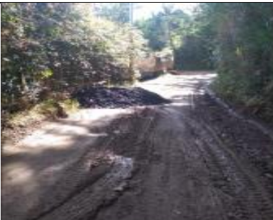
Figura 49. Construcción, ampliación o adecuación de vías urbanas y rurales 2022. Corregimiento Norte: Pavimentación La Laja.
