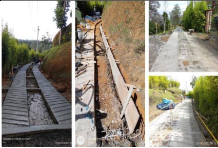
Figura 42. Construcción de placa huella 2022. Corregimiento Centro: vereda El Carmín, sector Los Rendones.
